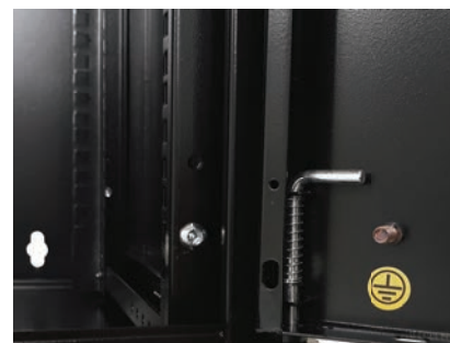
Singoli punti di messa a terra su tutta la struttura.
